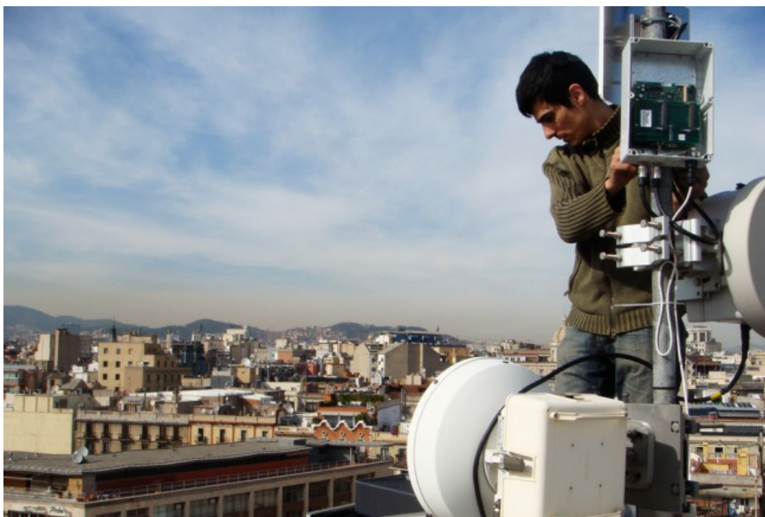
Instal·lació d'un node de la xarxa de telecomunicacions autogestionada de guifi.net Foto: guifi.net
